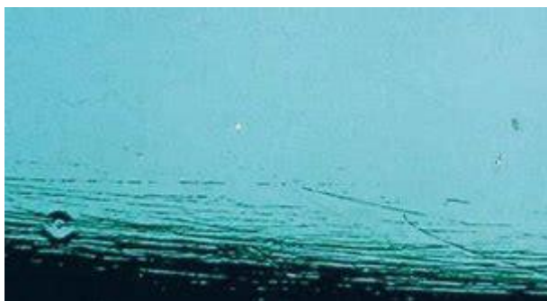
Schuurkrassen in de aflak zichtbaar
